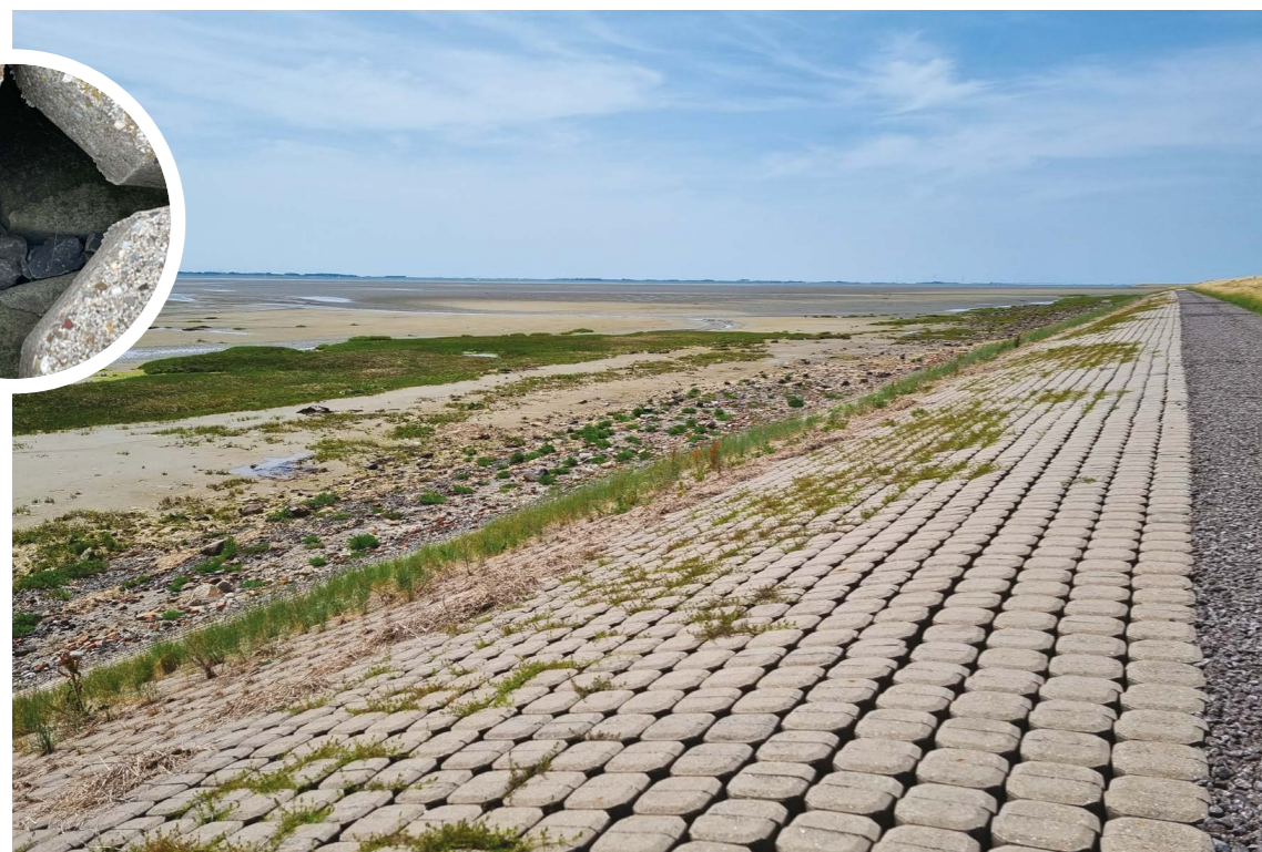
Hillblocks met gaten waar kuikens in vast komen te zitten. De dijk is hiermee ongeschikt geworden als broedplek.
